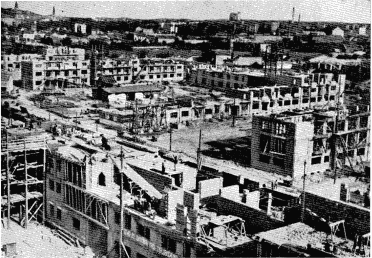
Сл. 7 — У априлу 1949 године почела је изградња четрдесет петоспратница станбеног насеља на Новом Београду. За три године подигнут је ту читав град.
